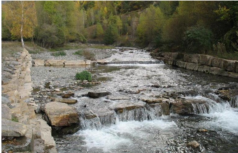
Figura 10-25. Cauce del río Vallfarrera con defensas y alteraciones en el lecho.
