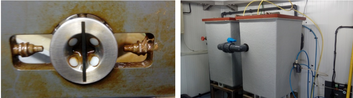
Figura 13. Turbidímetro Endress+Hauser® en la estación de calidad de aguas de Xerta (Izquierda) y, Doble tanque de decantación en el que se encuentra el turbidímetro tomando las medidas (Derecha)
