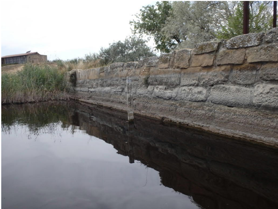
Infraestructuras en la cubeta
