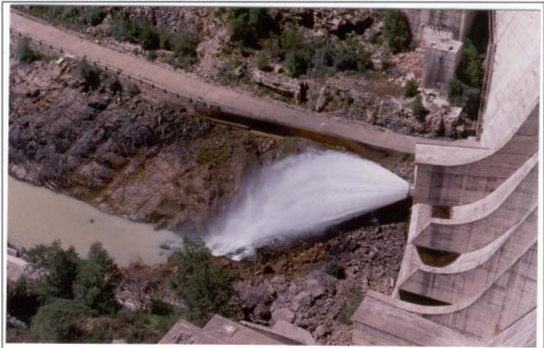
Desagüe de fondo y vertido del caudal ecológico en el río Gállego. Se aprecia la turbidez de las aguas.
